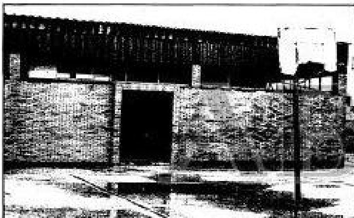
Tampoco las instalaciones deportivas del exterior se han librado del deterioro y la destrucción. Tras la cancha de baloncesto rota, tan sólo un cristal del gimnasio se ha resistido a las pedradas.
